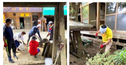
令和2年7月豪雨災害 ＜熊本支社＞
