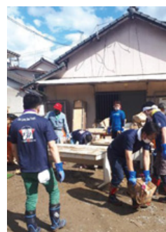
2020年熊本豪雨土砂撤去
