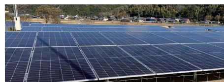
本社ビルに再生可能エネルギーを供給している施設
